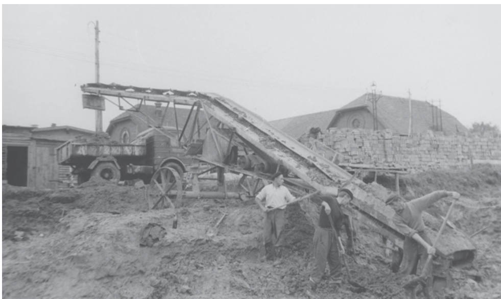
Rozbudowa Zakładów Mięśnych w Kępnie, początek lat 60. XX wieku. Wykopy pod budowę nowej kotłowni z kominem.
